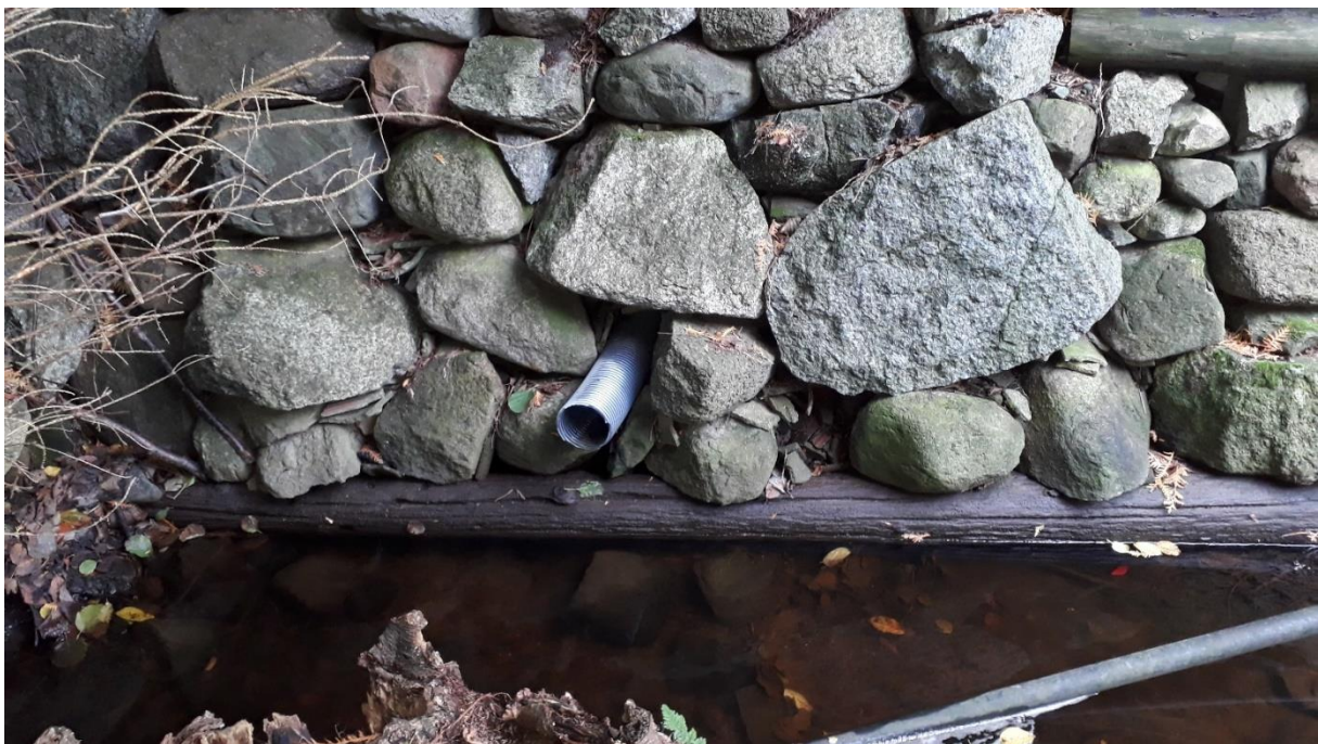
Rør fra svømmebasseng føres rett ut i bekken. Fra prøvestasjon 1 i Holtanbekken.
