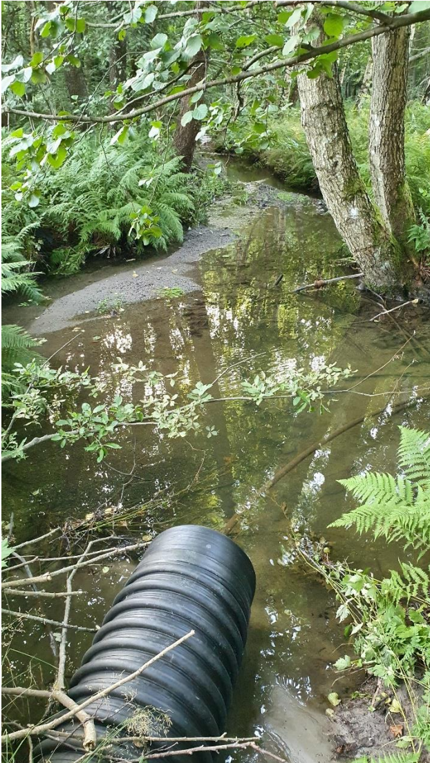
Figur 18. Utløpsrøret i punkt R2. Bekken er her bred og med lite fall. Det er en grunnere kulp i utløpet av røret.
