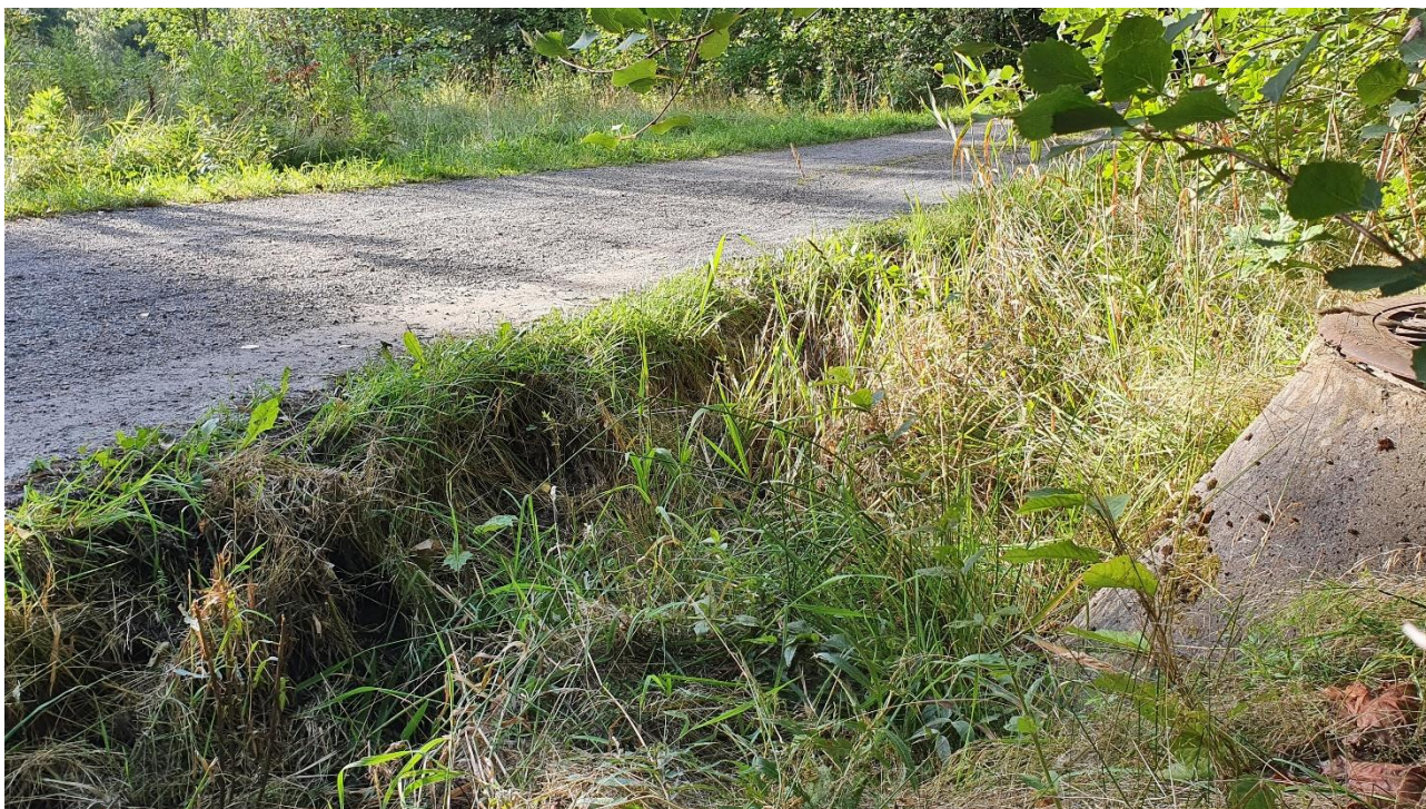
Figur 17. Kum K3 i høyre bildekant. Retningen mot kum K1 er øvre venstre hjørne av bildet. Det er også en rist over nedtakskum for grøftevann nede til venstre i bildet (ikke synlig).
