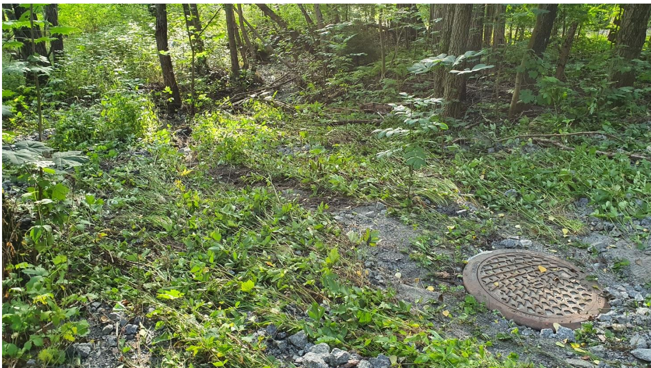
Figur 14. Kum K2 sett fra Djupsundveien mot øst. Erosjonsspor etter overløpssituasjon den 21. august 2020 sees ned mot det tørre bekkeløpet i bakkant av bildet. Foto: 27.08.2020.
