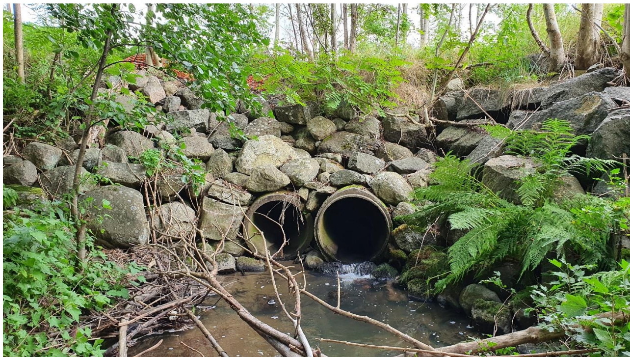
Figur 5. Utløpet av bekkelukkingen. Her kommer det ut to rør. Det ene var tørt på befaringdagen den 30.08.2020. Det antas at det vannførende røret er lukkingen av bekken. Det andre røret kan komme fra en nedløpskum i området.
