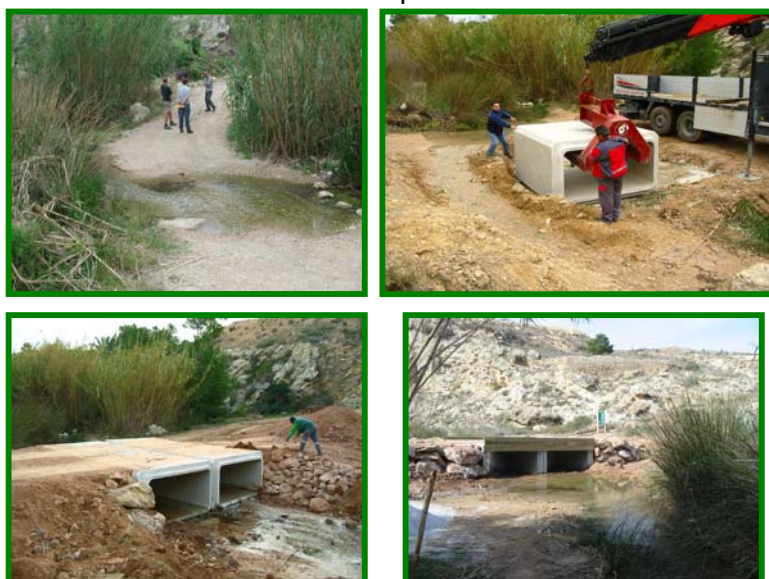
Figura 2. Construcción puente (aguas arriba de la charca principal de la cabecera del Río Chícamo)
