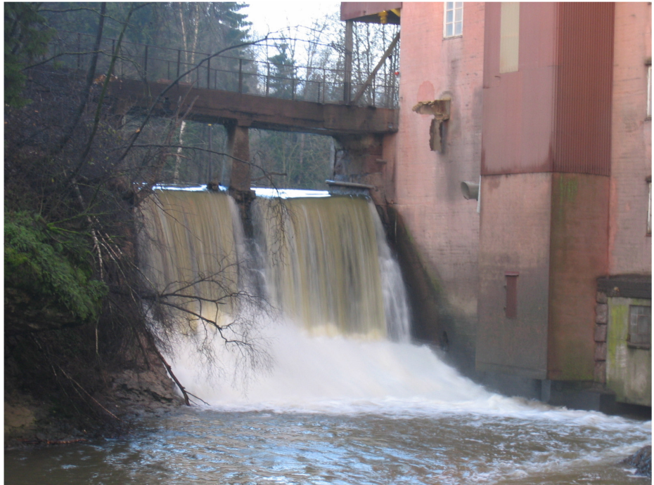
Dammen ved Borgen Mølle den 15.11.2006 under en mindre høstflom. Foto: Leif Simonsen.
